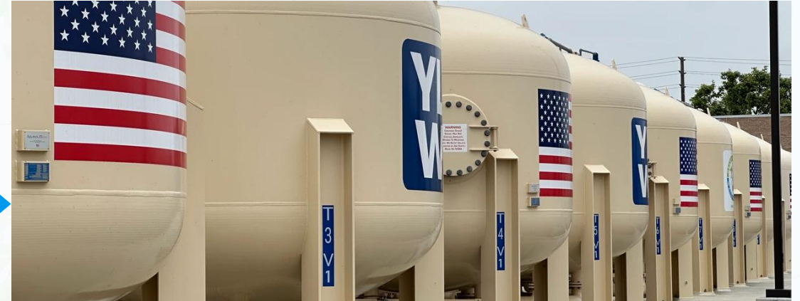
Planta de filtración de PFAS en Yorba Linda Water District, Orange County, CA. La mayor de Estados Unidos, inaugurada en 2024, con capacidad de ~3800 m 3 /h.
